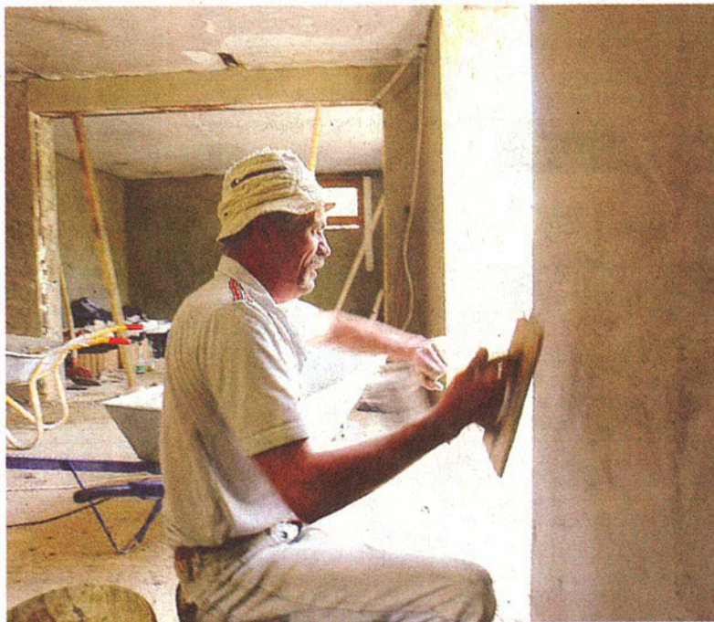
Baumängel sind nach einer aktuellen Studie des Bauherren-Schutzbund am häufigsten für Rechtsstreitigkeiten zwischen Bauherr und Unternehmen verantwortlich. Foto: djd/Bauherren-Schutzbund e.V.
